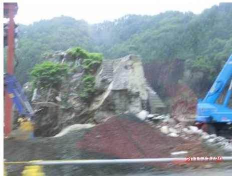
▲崩れた堤防～両脇に階段が残されている
