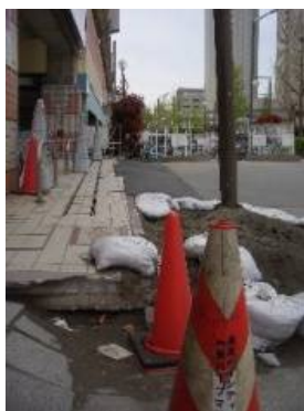
④駅ビルと周辺との段差
