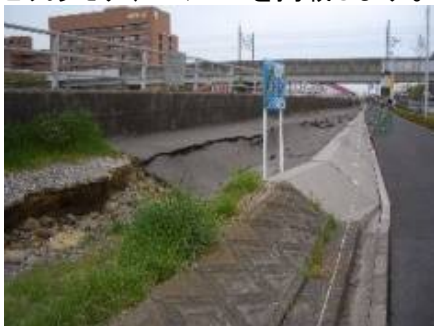
①崩れた堤防 入船地区
