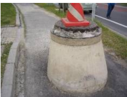
③液状化現象で、歩道から突出した 下水道マンホール
