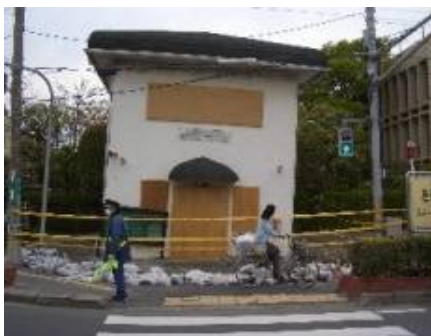
④傾き、陥没した交番
